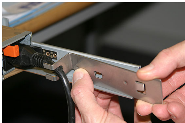
図 36. SAN ボリューム・コントローラー 2145-8F4 電源ケーブルへのケーブル保持ブラケットの取り付け
