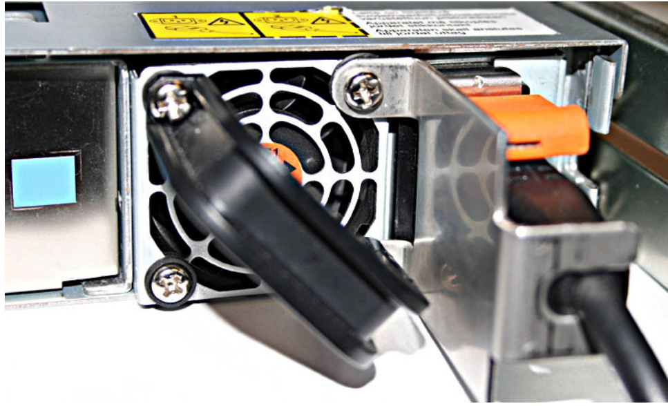
図 26. ケーブル保持ブラケットが取り付けられた SAN ボリューム・コントローラー 2145-8G4
