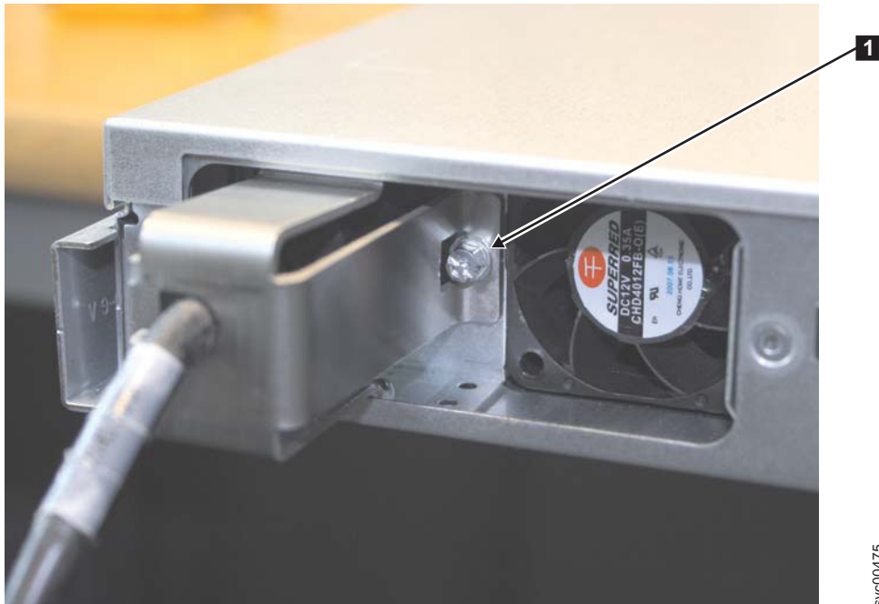
図 19. ケーブル保持ブラケットを取り付けた状態の SAN ボリューム・コントローラー 2145-8A4
