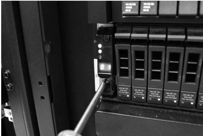
Abbildung 11. Gehäuse im Rackschrank sichern
